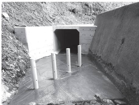
崩落土砂対策となる函渠型排水路
