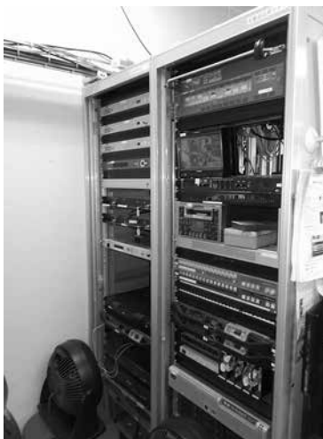
更新時期が迫る放送設備
