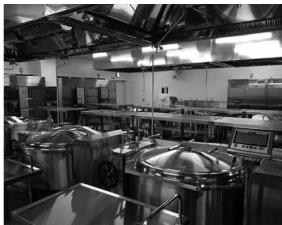
学校給食センター調理室
