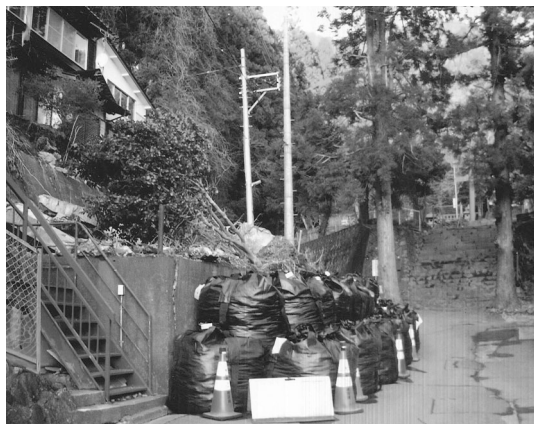
台風災害土砂崩れ現場
