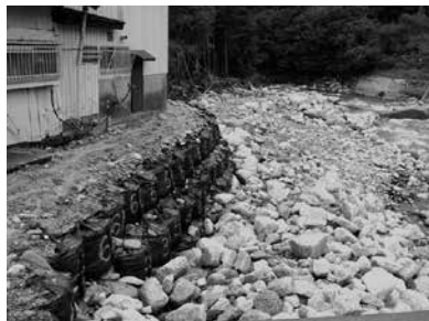
台風被害状況（中村橋から撮影）
