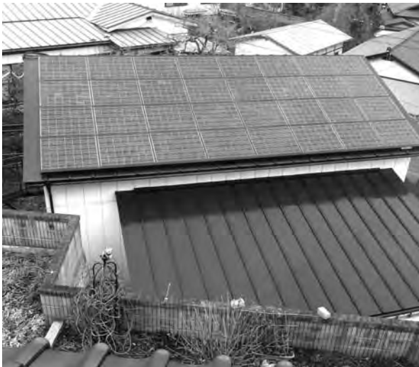
民家の屋根に設置された太陽光発電
