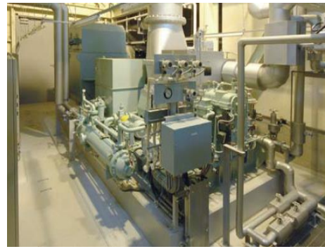
■蒸気タービン発電機
