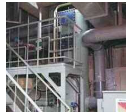
アルカリ触媒洗浄塔
