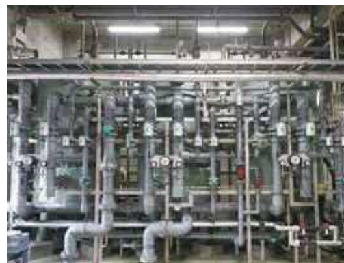
水処理活性炭吸着塔
