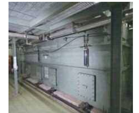
活性炭吸着塔
