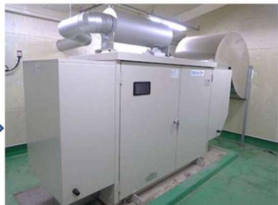
非常用発電設備
