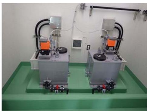
次亜注入設備
