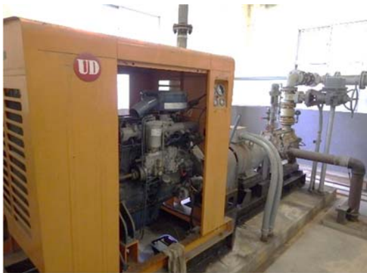
非常用エンジン
