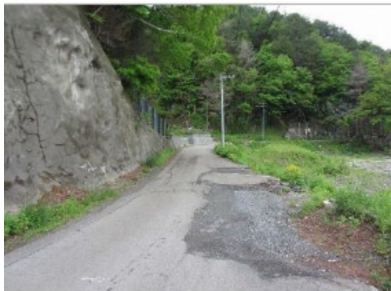
【整備前の旧県道の被災状況】
