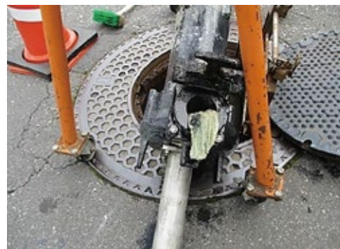
ポンプに詰まった異物
