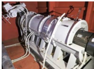
電力を生み出すタービン
