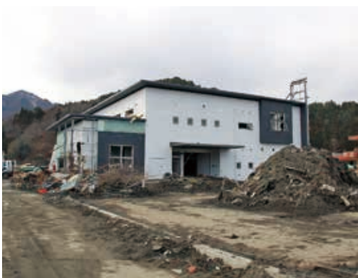
被災後の鶏住居地区防災センター・鶏住居町
