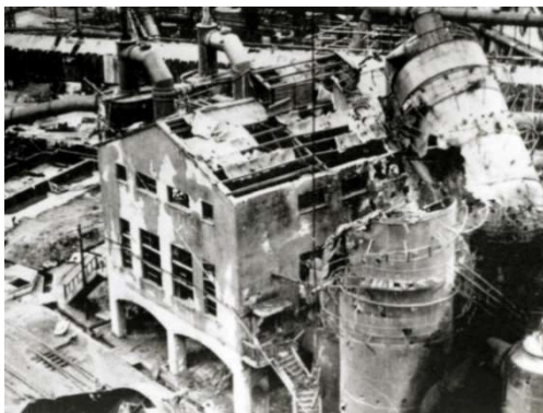
被害を受けた釜石製鉄所のガス清浄装置
