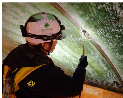
写真 3.2 応急措置(コンクリートうきの叩き落とし)
