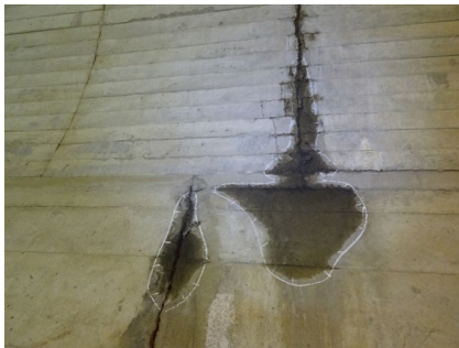
(対策前)打ち継ぎ目の漏水
