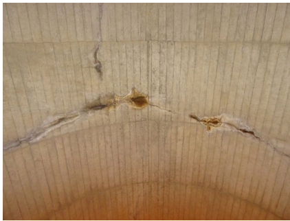
(対策前)アーチ部のひび割れ・うき
