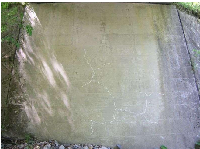
橋台【ひびわれ】
