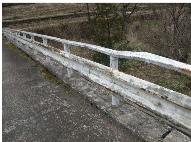
防護柵【腐食、変形】
