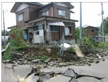
【写真-06】 2004年新潟県中越地震による被害
