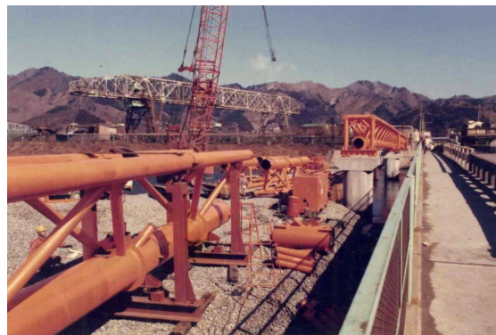
矢ノ浦水管橋施工状況 右端は架け替え前の旧矢ノ浦橋歩道
