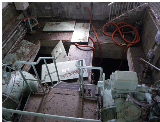
ポンプ槽上部の浸水による散乱
