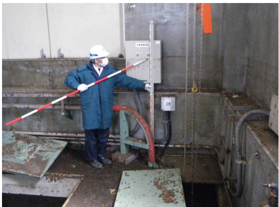
ポンプ槽上部の浸水高さ
