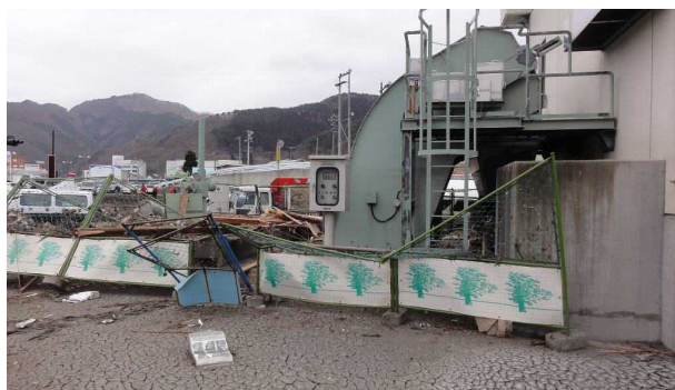
除塵設備。操作盤も浸水
