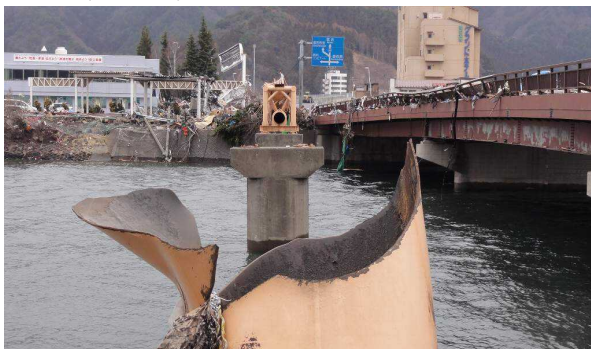
右岸(出口側)折損部と中間橋脚、残った部分を望む右岸橋台部
