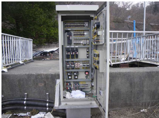
制御盤内部の状況
