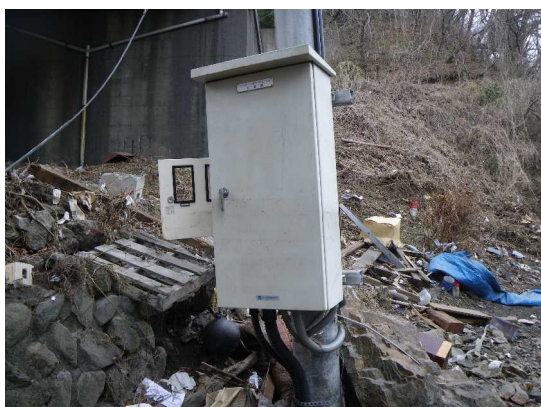
港町第1マンホールポンプ場
