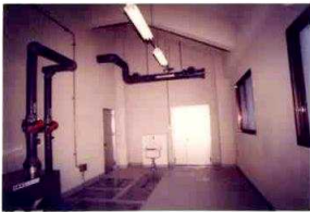
ばっ気沈砂槽
