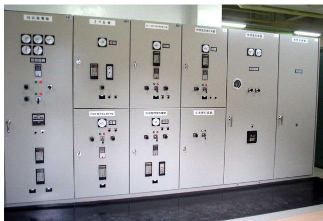
大平処理場電気設備更新(受変電)工事で設置された盤の一部
